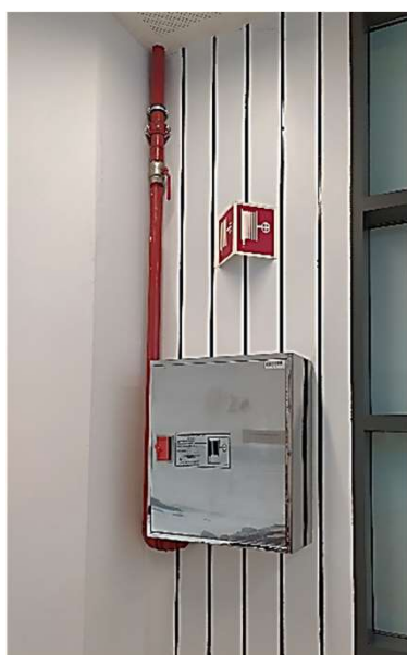
Instalação em centro comercial
